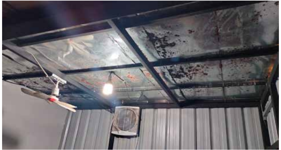
Booth kontainer di Kawasan Wisata Kuliner Sungai Tuak butuh perbaikan.
