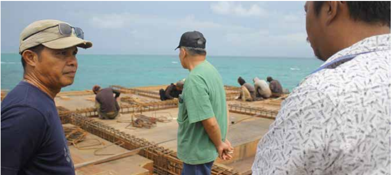
Ketua Komisi III DPRD Berau, Saga saat meninjau pembangunan Dermaga Pulau Derawan.
