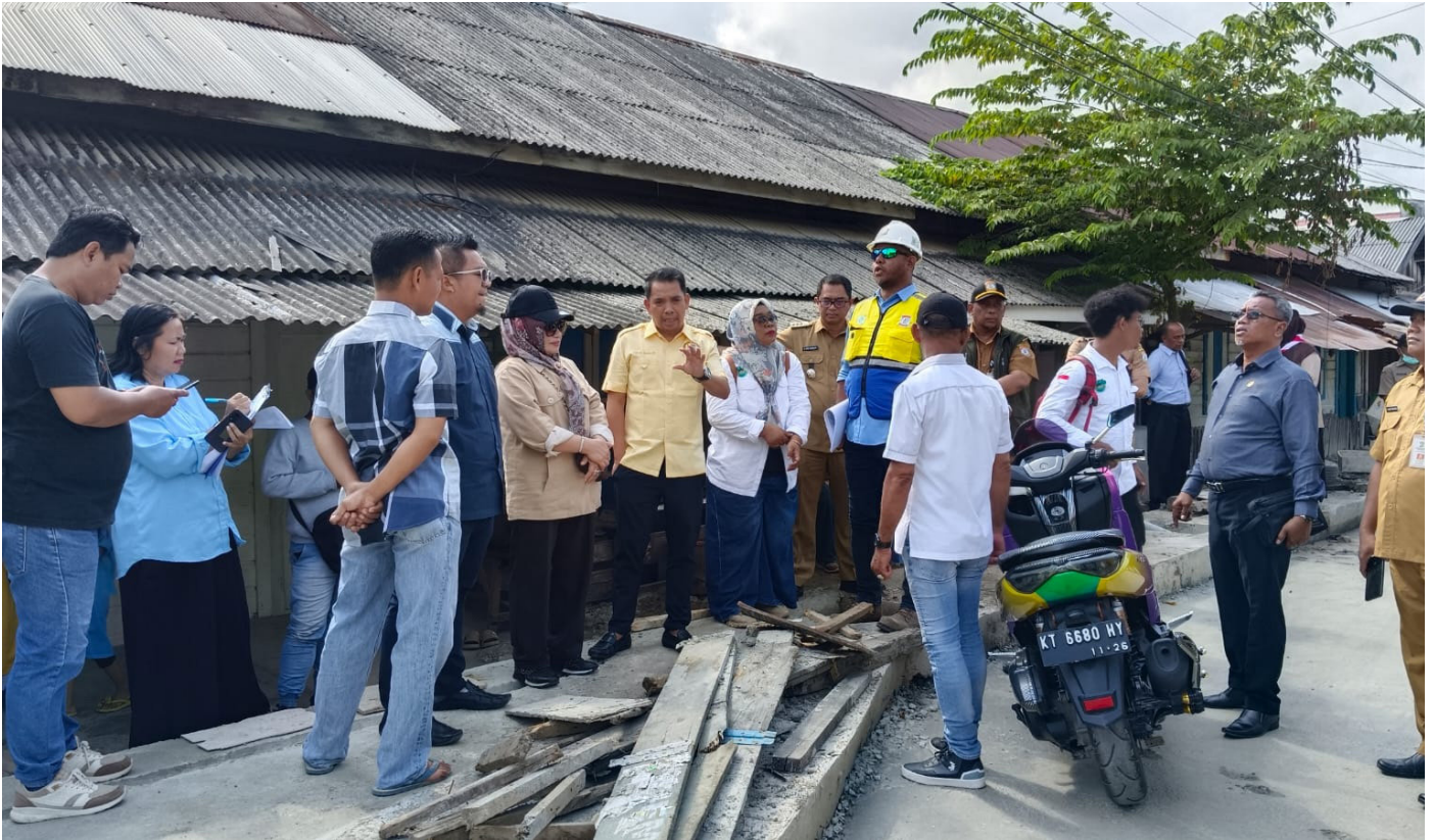
Komisi III DPRD Balikpapan melakukan sidak drainase di kawasan jalan Wolter Monginsidi RT 31 Kelurahan Baru Ulu, Kecamatan Balikpapan Barat.
